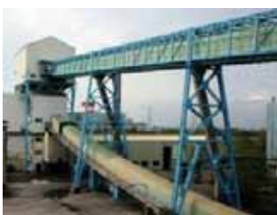
ベルトコンベヤー火災検知
