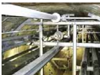
トンネルの火災検知
