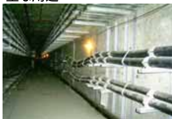
地中送電線温度監視
